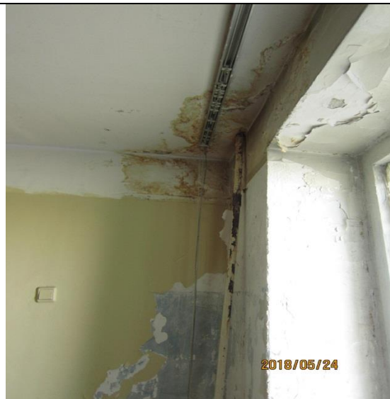
Pic 1.1 Roof leakage / Дээврээс ус гоожсон байдал
