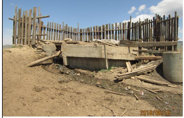
Pic 1.4 Temporary protective fencing around the sewage pit / Цэвэрлэх байгууламжийн түр хашлага 2018.06.16
