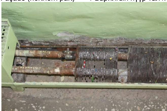
Heating pipes / халаалтын шугам
