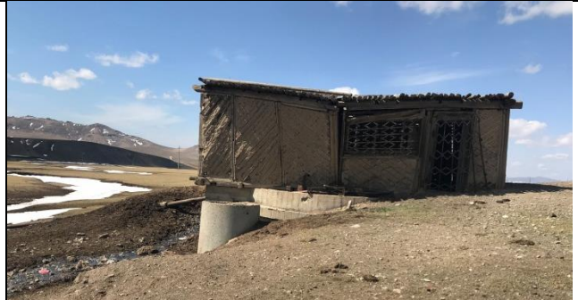
Pic 1.2 Protective shield above the sewage pit / Цэвэрлэх байгууламж дээрх хамгаалалт 2018.04.16
