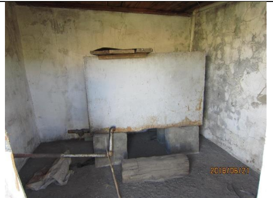
Pic 1.2 Inside of water well building #1 Гүний худгийн барилгын доторх байдал
