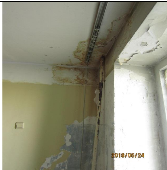
Pic 1.1 Roof leakage / Дээврээс ус гоожсон байдал
