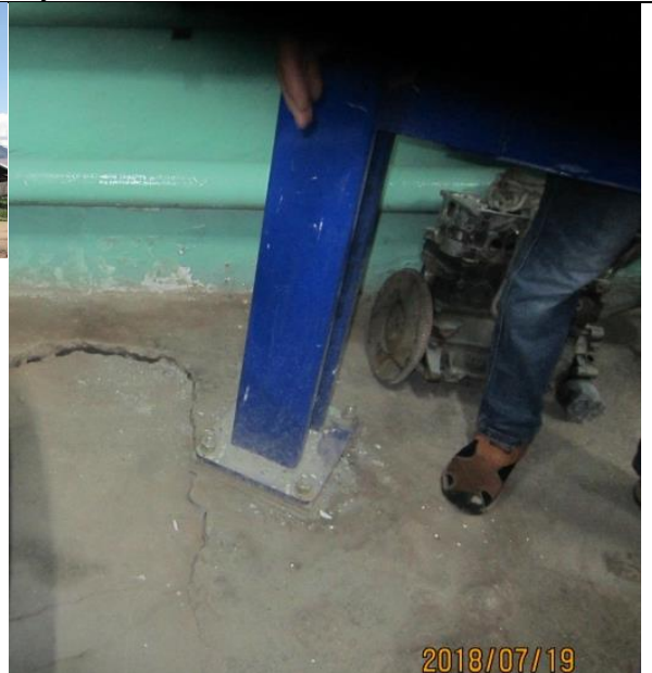
Pic 1.4 The footprint of one pole of the existing 4 post car lifter / 4 баганатай авто өргөгчийн нэг тулгуурын доорх эвдэрсэн шал / суурь
